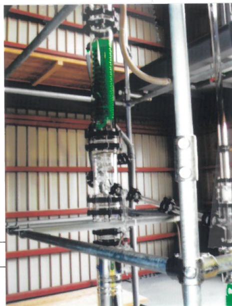
▲ 装置全体 (一部)
